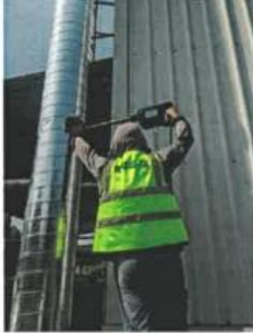
挤出废气排气筒
