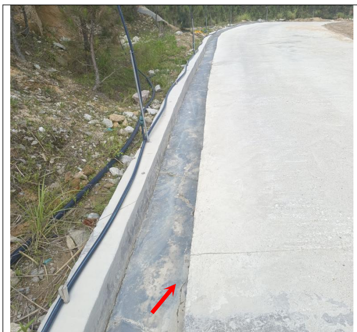
图4-11 项目截排水沟
