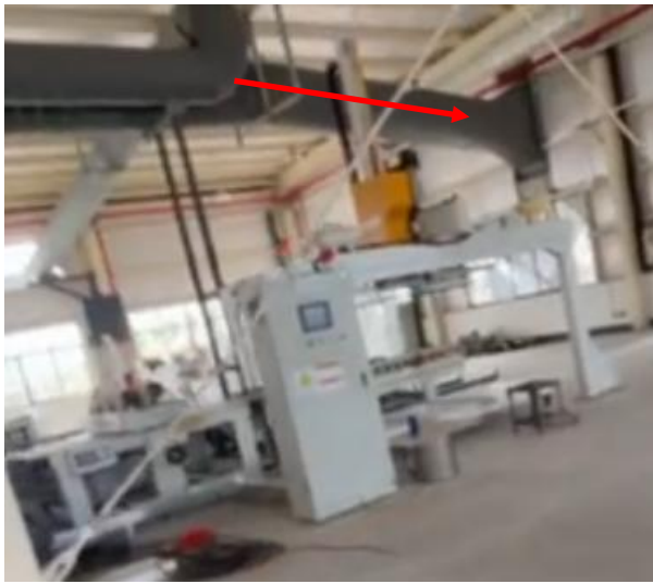
车间内废气收集管道
