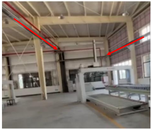
车间内废气收集管道
